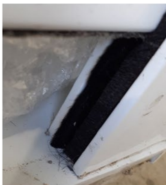
Foto 4 – Escovas presentes na guia de deslizamento da esteira da persiana.
