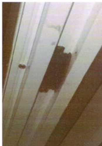
Foto 4 – Manta de composto plástico coberta por aparato plástico presente na travessa superior do marco.
